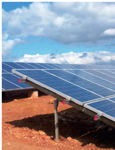
光伏地面电站
