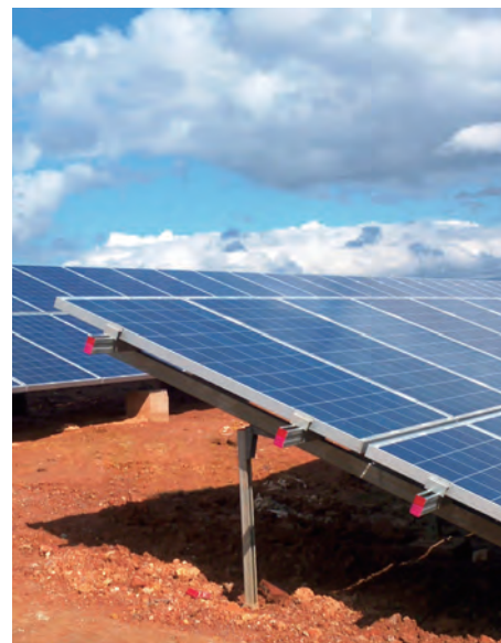
光伏地面电站
